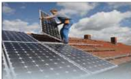
Photovoltaïsche installaties (zonnepanelen)
